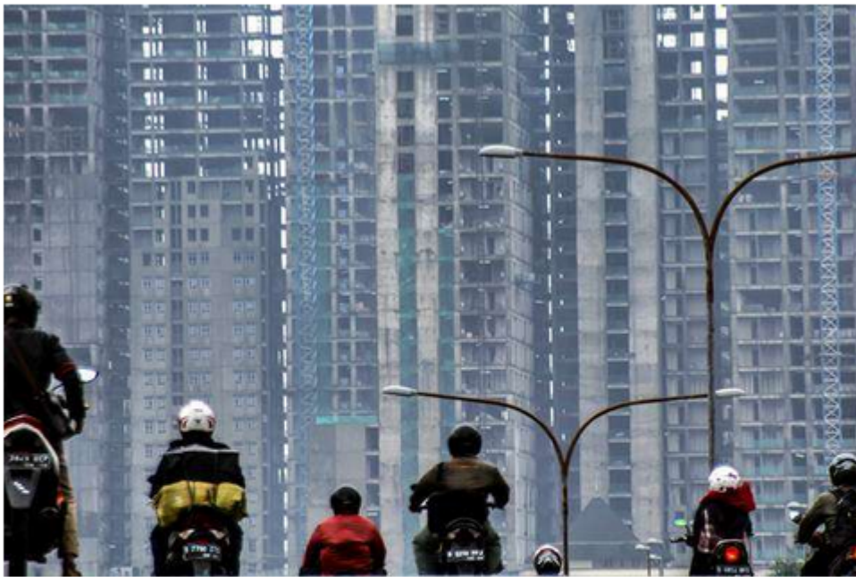
Kendaraan melintas dengan latar belakang pembangunan gedung bertingkat di kawasan Kemayoran, Jakarta, Senin (20/2). - Antara/Aprillio Akbar
